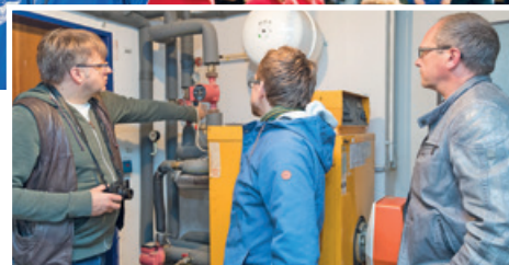
Energieberater Jürgen Strege erläutert den beiden Vereinsvorsitzenden Andreas Burmester und Torsten Escher die Optimierungsmöglichkeiten der Heizanlage (v. l.). Foto: Oliver Huchthausen
