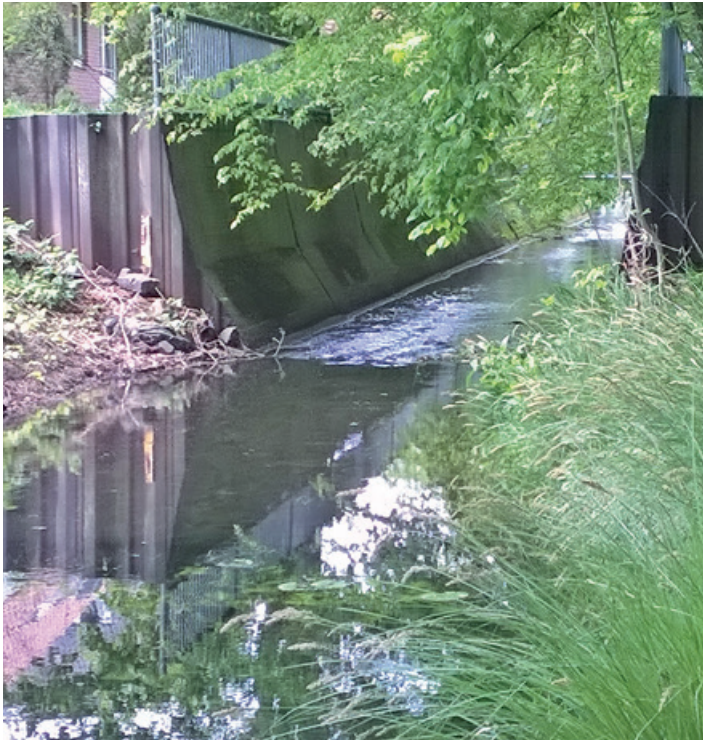
Steinhuder Meerbach bei Rehburg: Kanuten dürfen Ufer nicht betreten.
